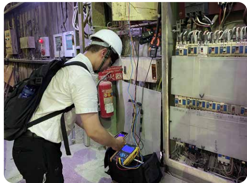
▲園管局節能輔導團針對關鍵製程設備進行能耗診斷與掛表量測，協助弘偉環保工程精準掌握設備稼動率與能耗狀況。
